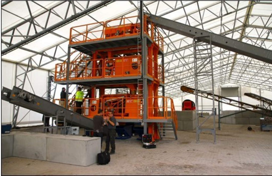
Figur 3 Anlæg til sortering af ikke-magnetiske metaller fra slaggen. Anlægget består af 2 serieforbundne hvirvelstrømsseparatorer og foran disse en magnetseparator. Anlægget er leveret af SGM Gantry (Italien).
